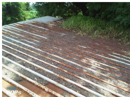
HET LEKKENDE DAK VAN DE VERPLEEGSTERSFLAT IN MANDISI MALAWI
